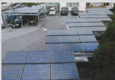
太陽光発電設備(9.2kW)
